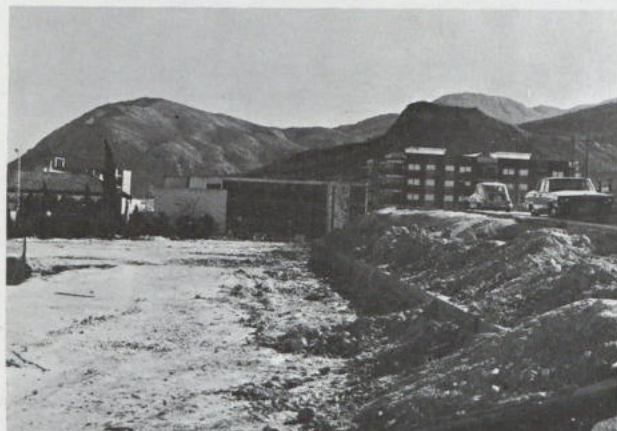
Emplazamiento de las obras de ampliación del Instituto y trabajos de cambio de trazado de la red de agua.
