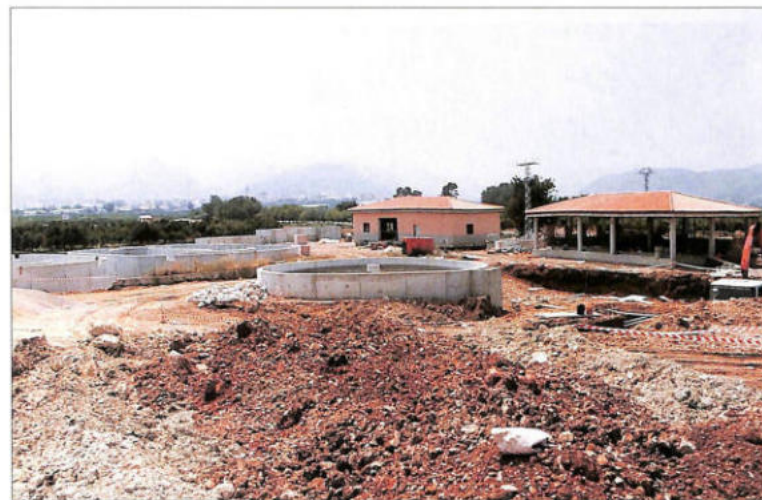
3.- Construcción depuradora municipal, con aprovechamiento de aguas residuales para riego.
